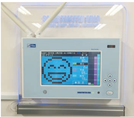
電気の見える化装置により、電気の使用状況が一目で分かります。
